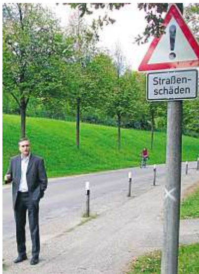
Stadtrat Dr. Burger begutachtet den aktuellen Zustand der Straße. Schilder warnen vor Schäden. Foto: SPD
